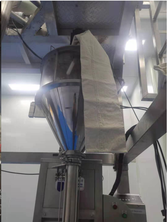
图 6-2 项目布袋除尘器
